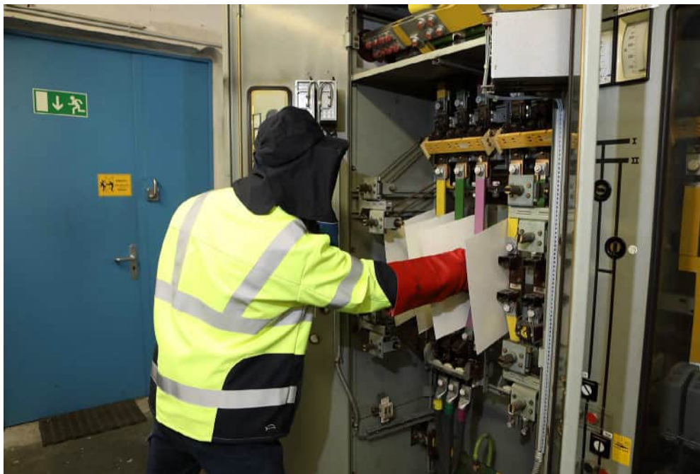
Abb. A 5-20 Entnehmen der NH-Sicherungseinsätze, zusätzlich mobile Trennsteg um Potentiale gegeneinander zu isolieren
