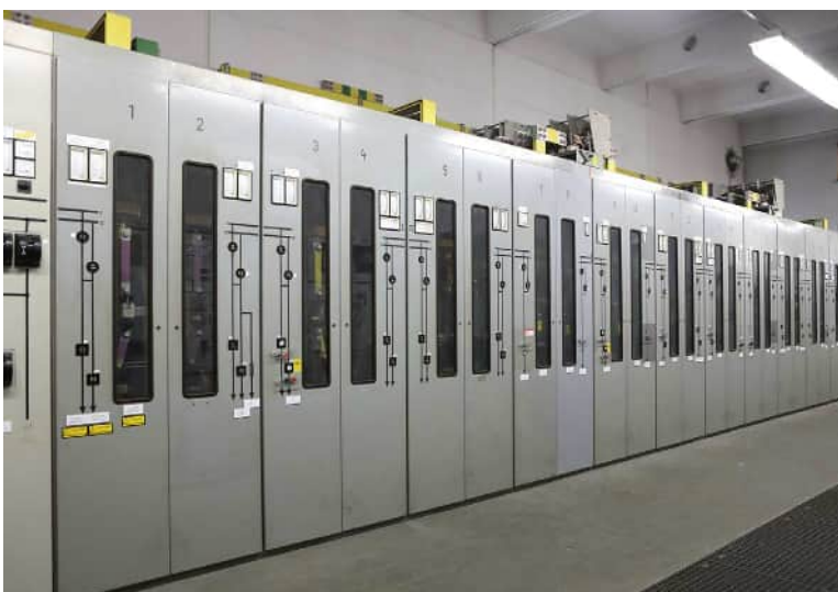
Abb. A 5-17 Leistungsstarke Schaltanlage älterer Bauart; eingesetzt in der Industrie
